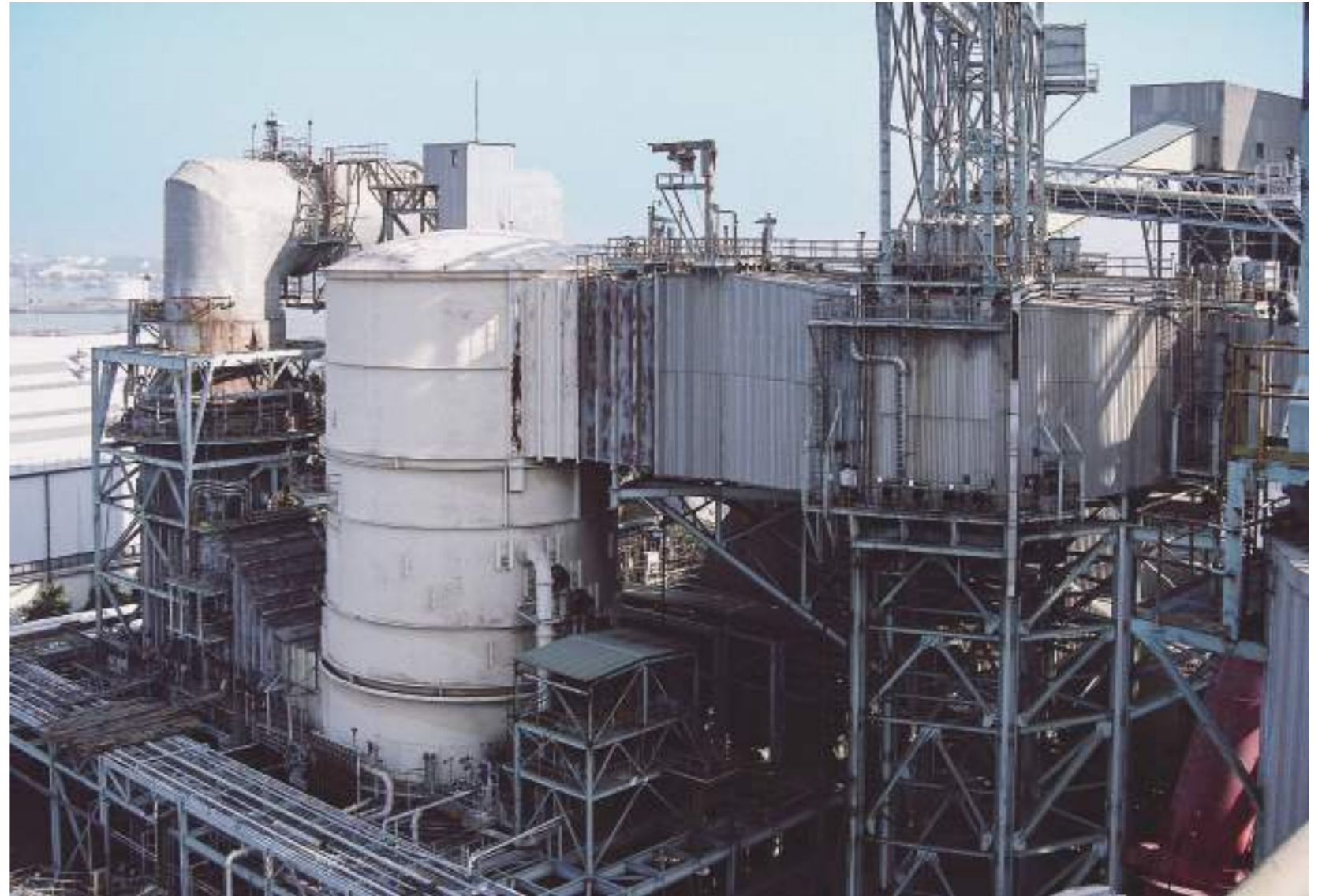
2008년 10월 13일, 신타 화력발전소 1, 2호기 탈황 설비, 및 전기집진기, 회처리 설비 등에 대한 성능개선 공사 입찰에서 낙찰자로 선정되었다.
