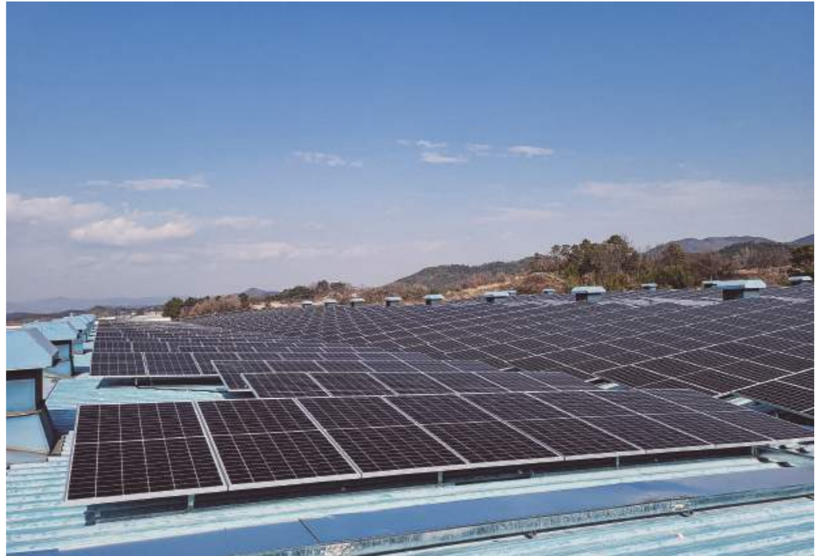
KC솔라&에너지가 직접 투자해 BHI(주) 장지공장 지붕에 설치한 태양광발전소.
